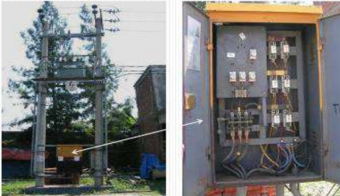
Gambar 2-37. Gardu tiang tipe portal dan Midel Panel
